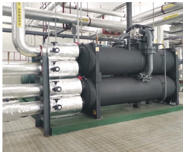
天津数据中心的余热回收系统
