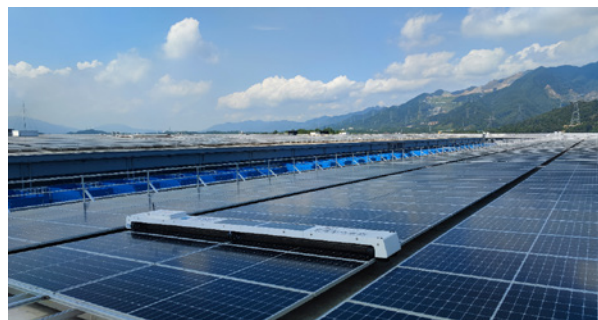
腾讯数据中心屋顶光伏
